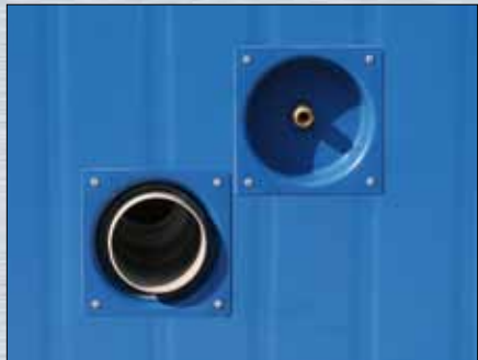
Wasseranschluss, in der Wand versenkt
